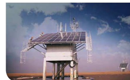
晶澳上海崇明离网项目 JA Solar's Shanghai Chongming Off-Grid Project
